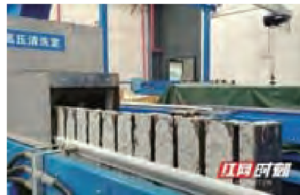
使用过的模具由自动清洗设备入口进入高压清洗室
